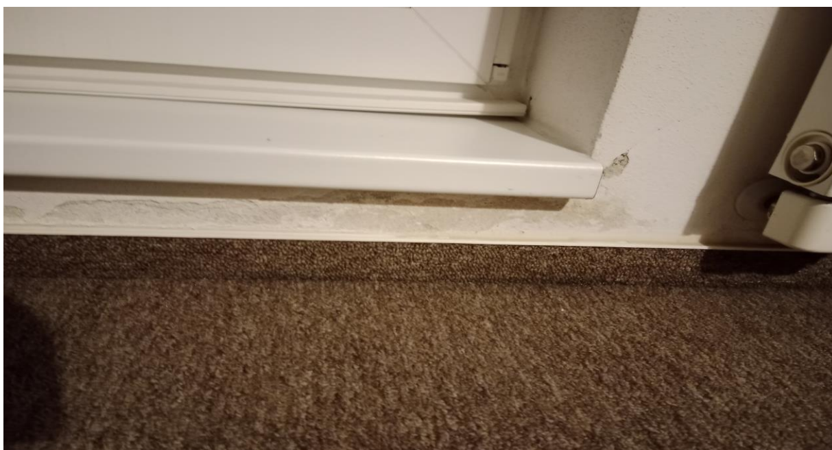
Pronikání vlhkosti do interiéru u (pod) balkonových dveří
