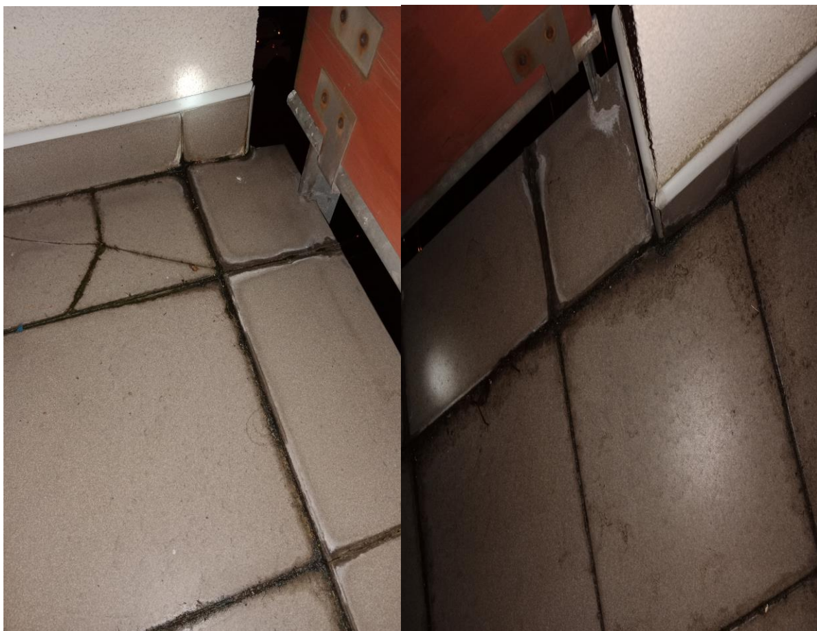
Odpadlá dlažba včetně destruovaných spár
